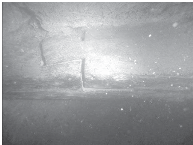
Рис. 13. Стыки дубовых балок основания башни.
