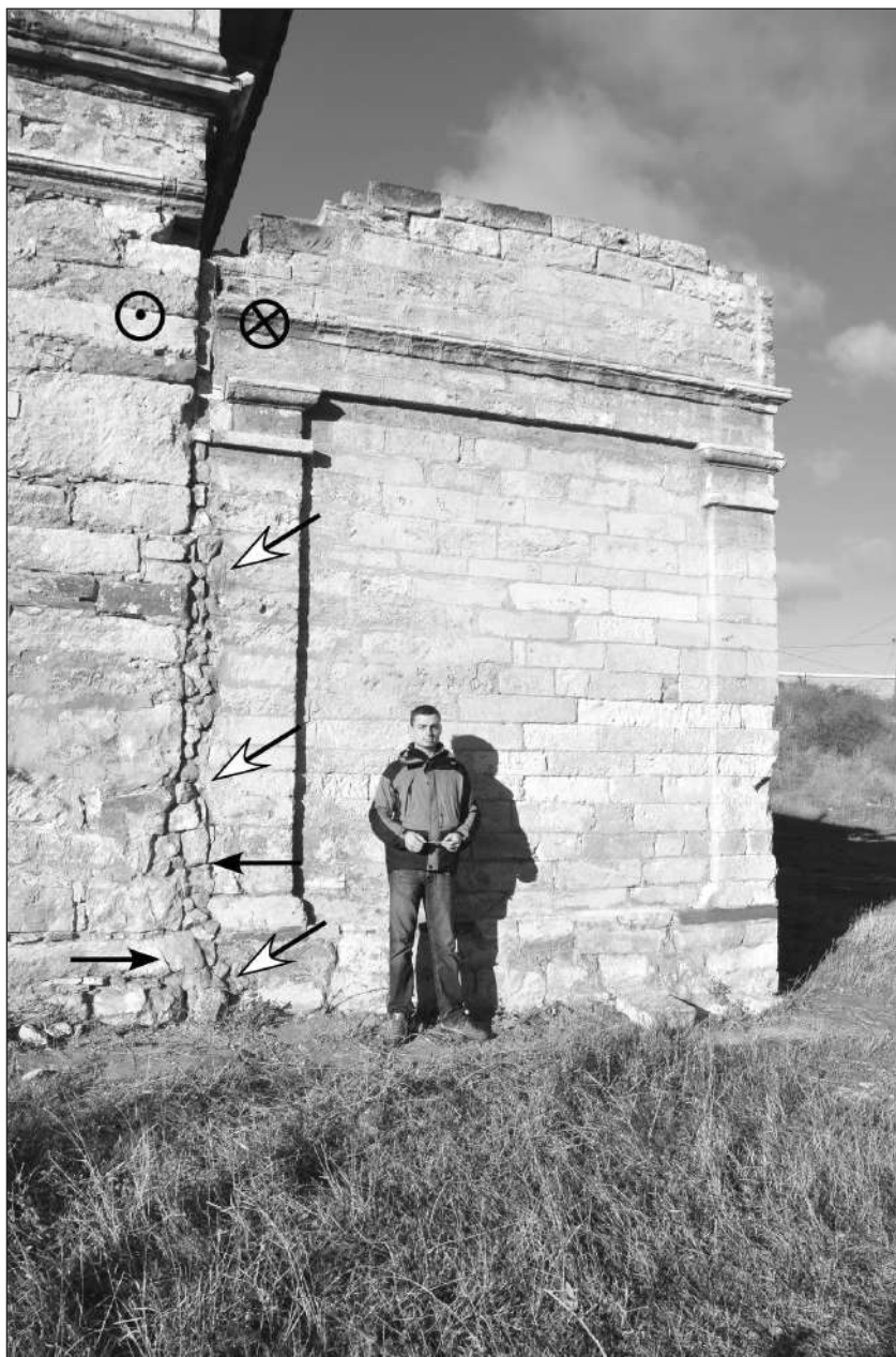
Рис. 5. Разрыв (показан наклонными стрелками) между параллельными восточными стенами старой части храма (слева), построенной в XIV веке, и пристройки (справа), построенной в XIX веке. Стена пристройки наклонилась на запад – от зрителя (значок, показывающий оперение стрелы). Горизонтальные стрелки показывают сквозные трещины, пробивающие два каменных блока. Вид на запад – северо-запад.
